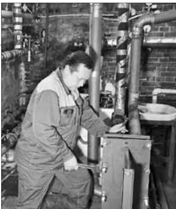
■ В банях на Логинова идет подготовка теплоузла
